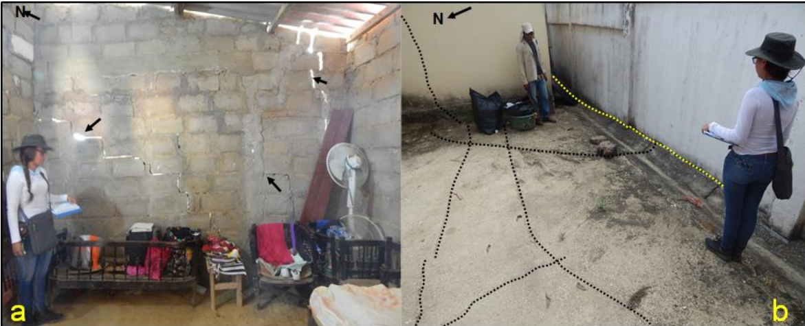
Fotografía 3.44. a) grietas en viviendas, b) grietas en paredes y pisos del colegio de la Tabla.
